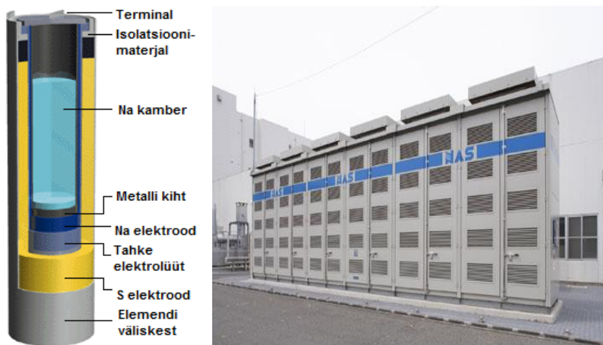
Joonis 2.9 Väävel-naatrium aku ehitus ja akujaam 34
